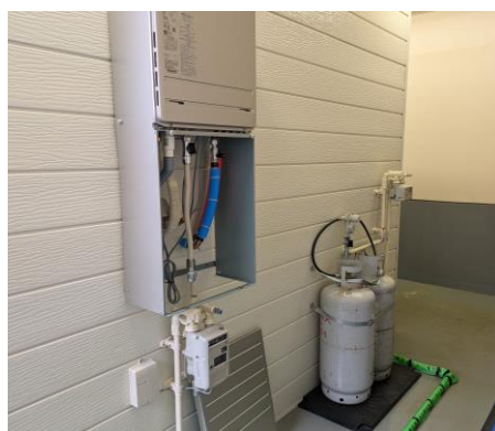
給湯器と供給設備
