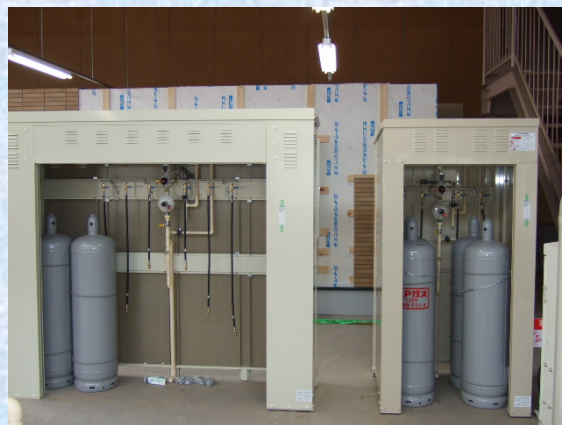
シリンダー供給設備
