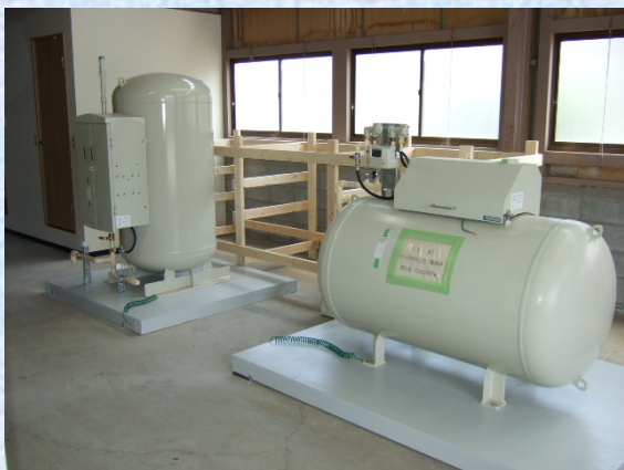
バルク供給設備
